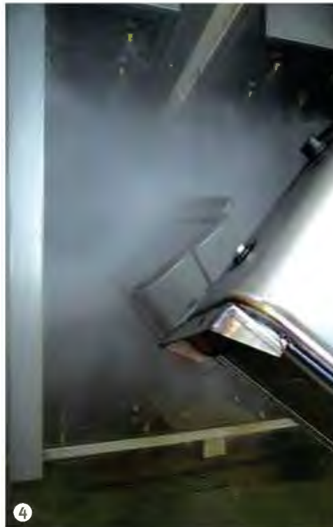
Figura 4: I serbatoi all'interno del tunnel di pretrattamento.
